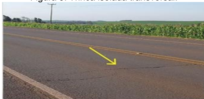
Figura 9: Trinca isolada transversal.
