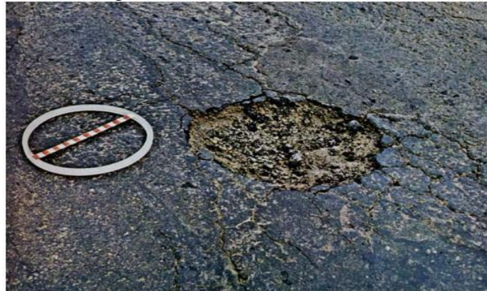
Figura 20: Panela ou Buraco.
