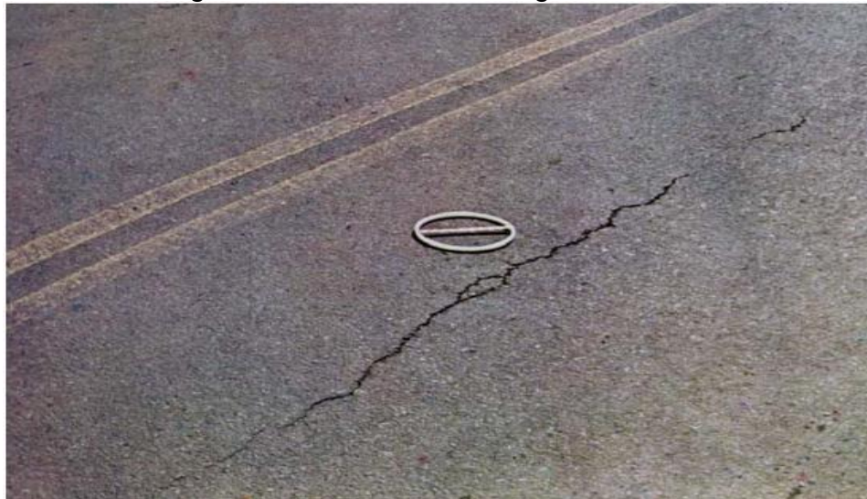
Figura 10: Trinca isolada longitudinal.
