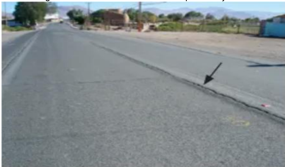
Figura 11: Defeito de trinca isolada por retração.
