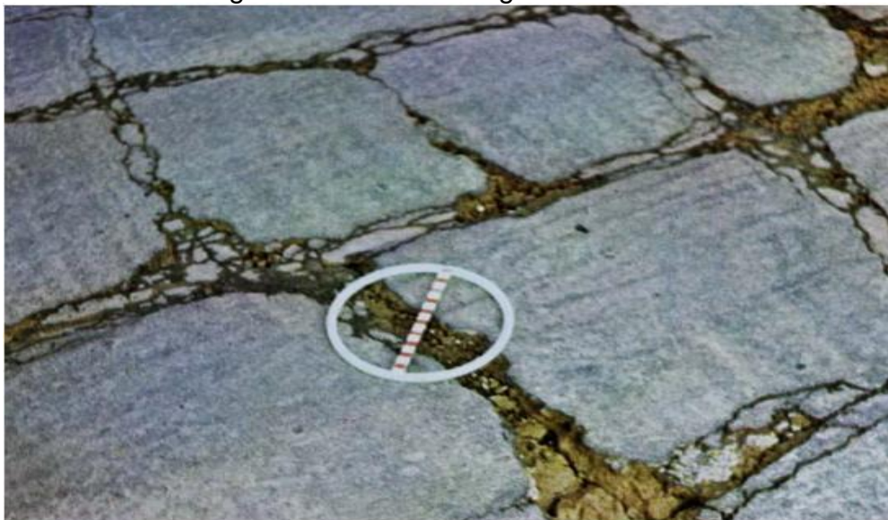
Figura 13: Trinca interligado bloco.
