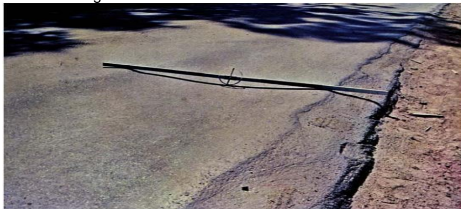
Figura 15: Afundamento de trilha de roda.
