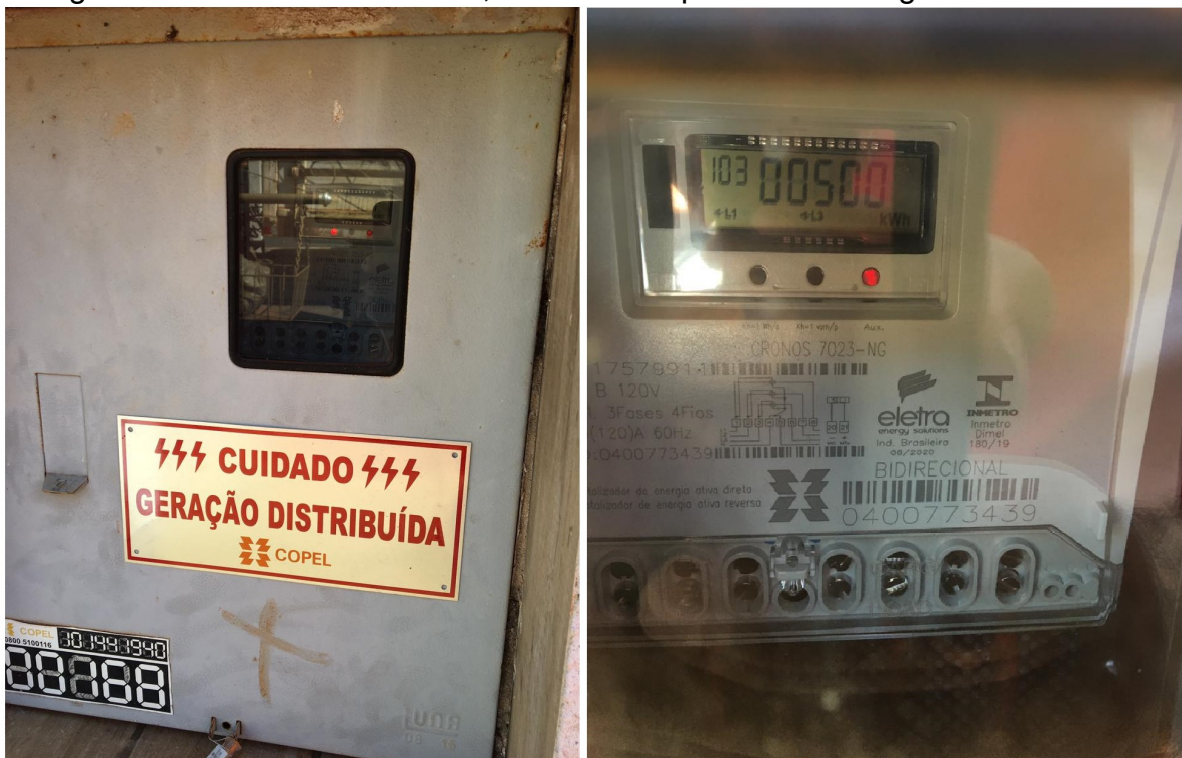
Figura 12: medidor bidirecional, instalado no padrão de energia da residência.
