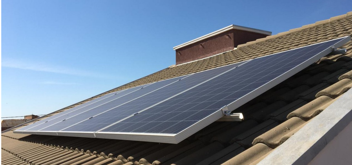
Figura 11: módulos BEDINSOLAR 390W instalados na residência.
