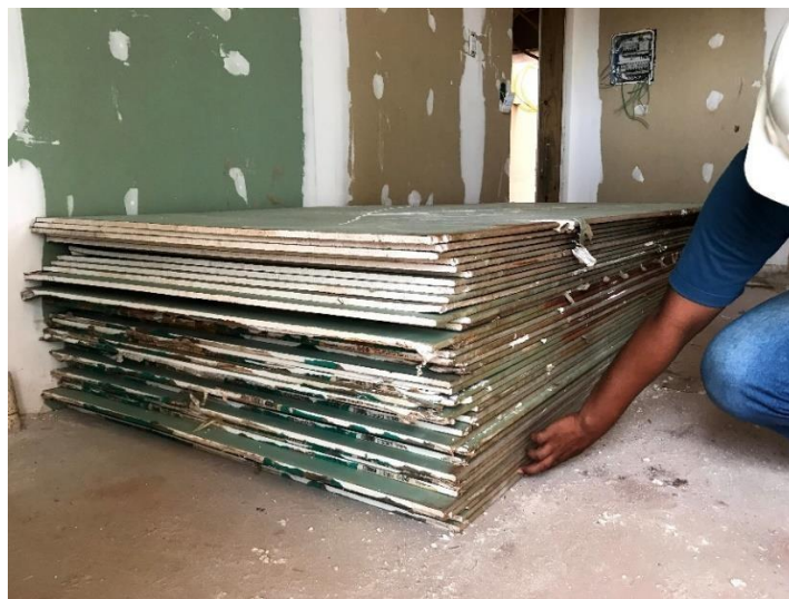
Figura 08: Placas de gesso danificadas pelo mau armazenamento. 15/01/2021
