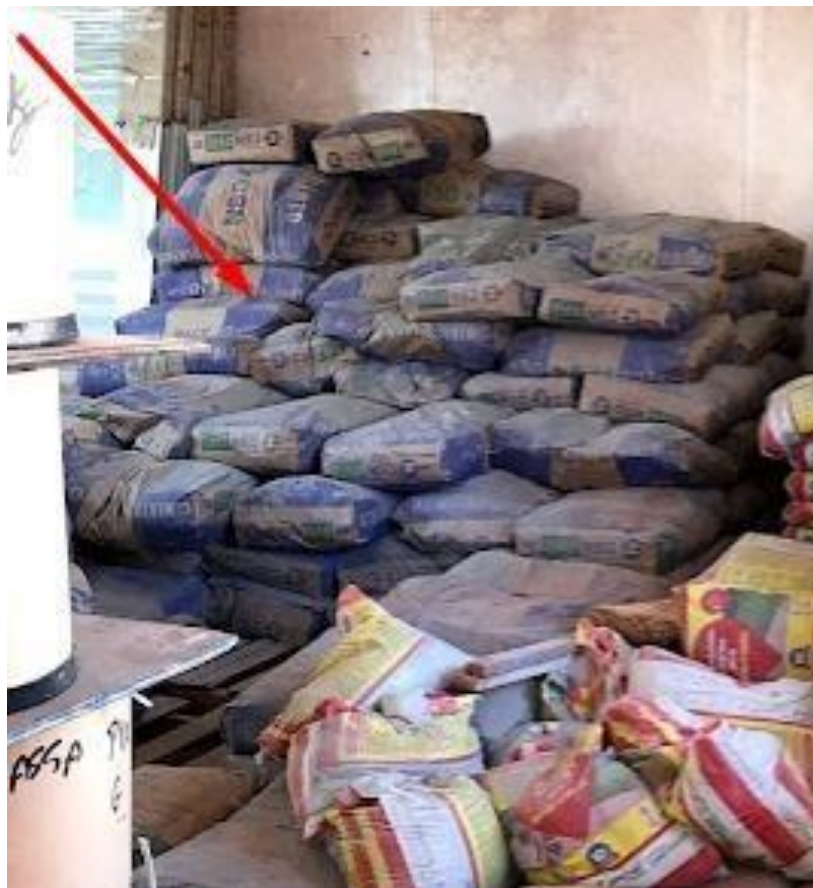
Figura 11: Cimento armazenados no interior do almoxarifado da obra. Data 04/02/2021.
