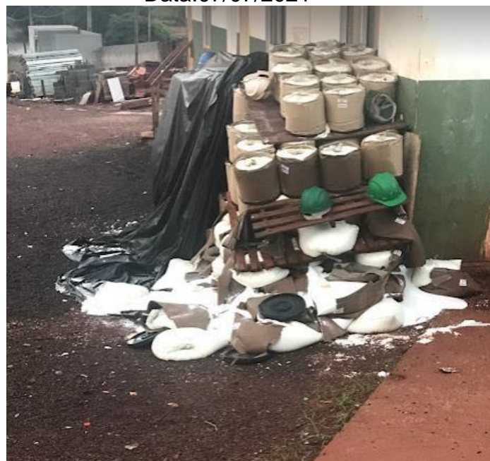
Figura 30: Massa Acrílica armazenada sem proteção no canteiro de obra. Data:07/07/2021
