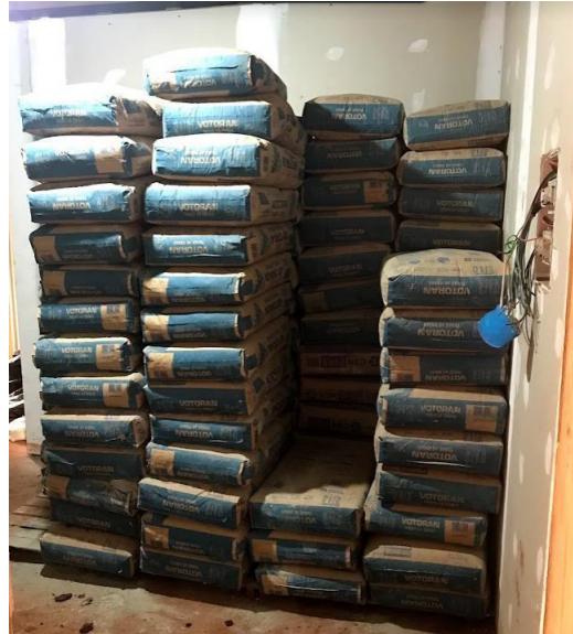
Figura 12: Cimento armazenados no interior do almoxarifado da obra. Data 08/10/2021
