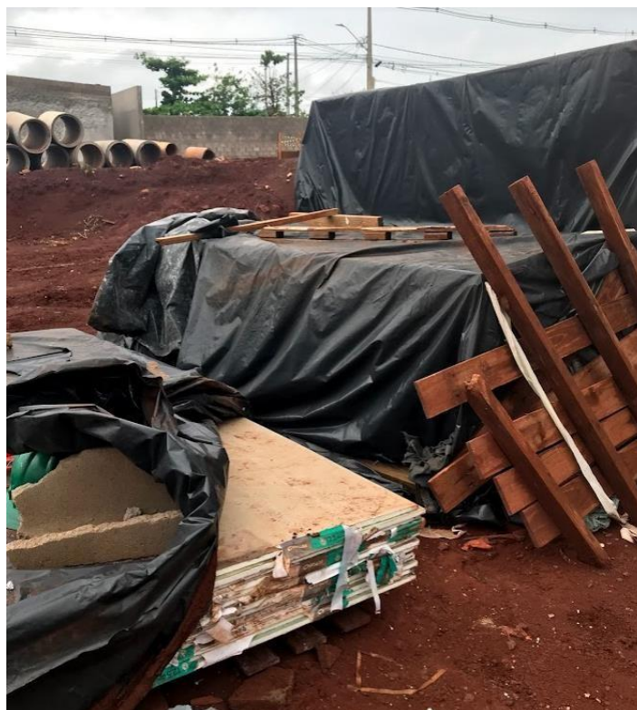
Figura 10: Placas de gesso danificadas pelo mau armazenamento. Data 08/10/2021
