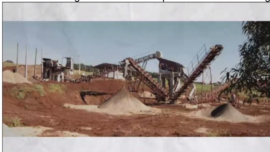
Figura 06: Usina fixa de reciclagem de RCC da empresa fornecedora do agregado.
