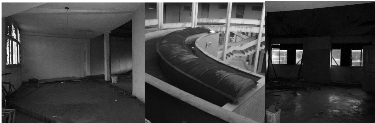
Figura 55 – Patologias conseqüentes da falta de manutenção da edificação.
