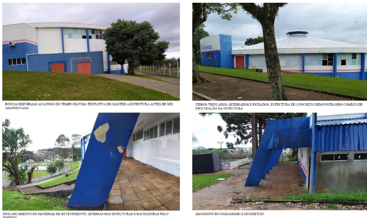
Figura 51 - Apresentação dos problemas da edificação existente.
